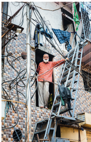
Un uomo si affaccia dal suouscio di casa, attraversato daicavi che deviano l'elettricitàdalla rete principale, nello slumdi Dharavi, Mumbai. India, 2019
